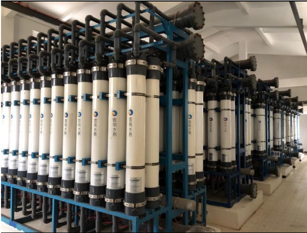
图 43: 银桥水厂超滤膜组
